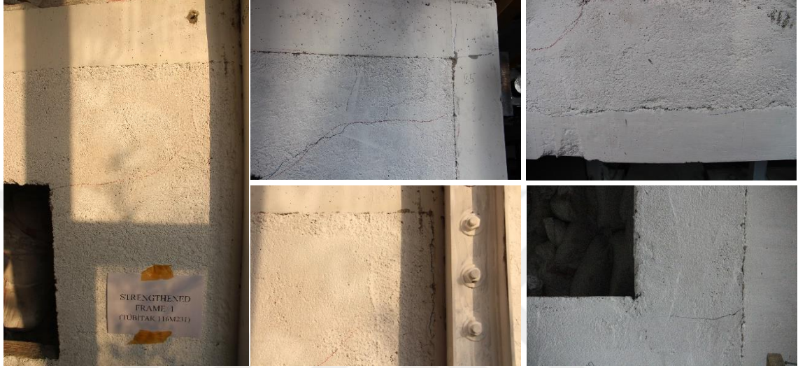
Şekil 4.63 %0,3 görelî kat ötelemesinde gözlenen hasarlar
