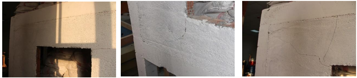
Şekil 4.64 %0,5 görelî kat ötelemesinde gözlenen hasarlar
