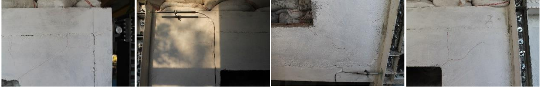
Şekil 4.71 %0,3 görelî kat ötelemesinde gözlenen hasarlar
