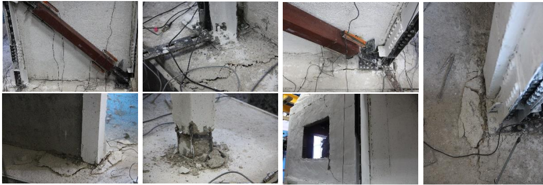
Şekil 4.68 %2,5 görelî kat ötelemesinde gözlenen hasarlar
