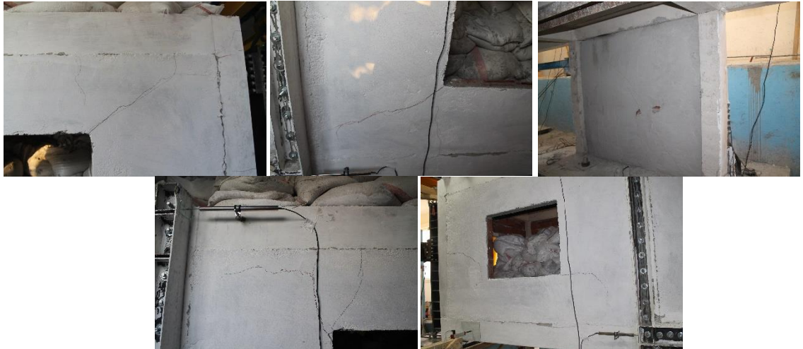
Şekil 4.73 %1 görelî kat ötelemesinde gözlenen hasarlar
