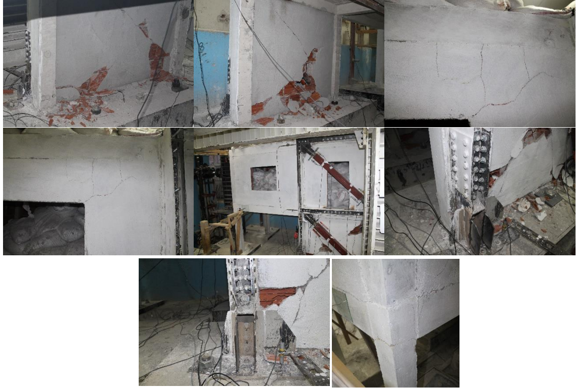
Şekil 4.75 %2 görelî kat ötelemesinde gözlenen hasarlar
