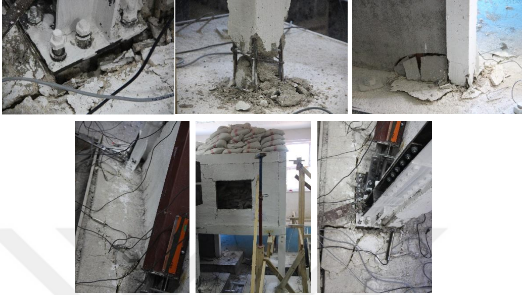
Şekil 4.69 %3 görelî kat ötelemesinde gözlenen hasarlar
