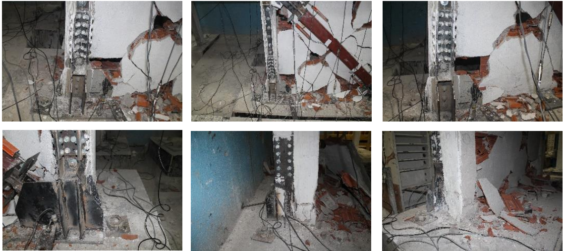
Şekil 4.77 %2 görelî kat ötelemesinde gözlenen hasarlar
