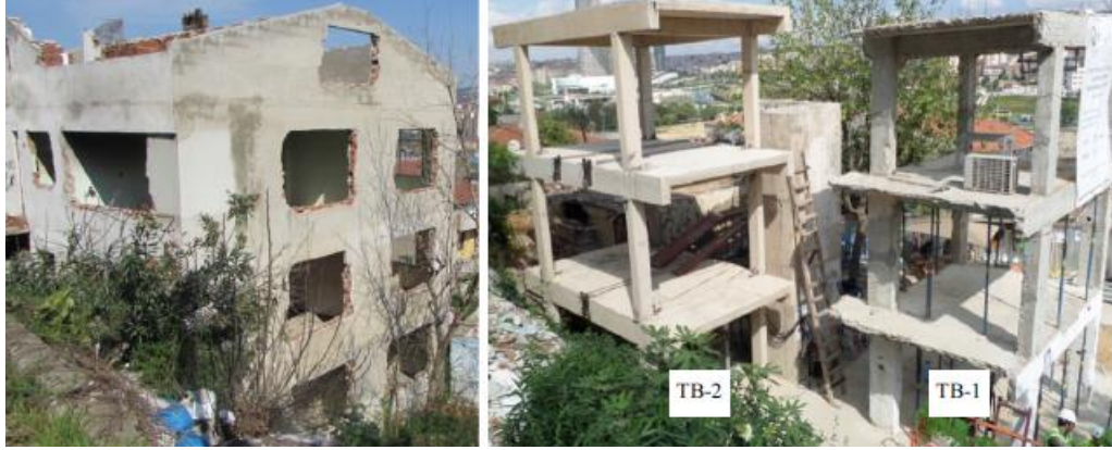
Şekil 2.6 Ölçümlerin yapıldığı kusurlu betonarme binalar(Göksu vd. 2017)
