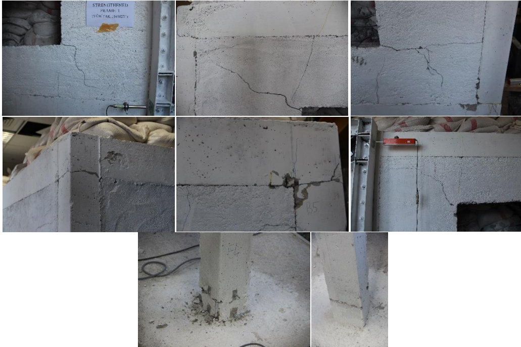
Şekil 4.66 %1,5 görelî kat ötelemesinde gözlenen hasarlar
