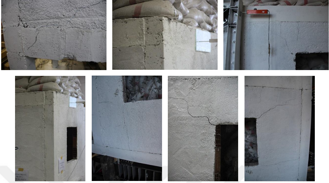
Şekil 4.65 %1 görelî kat ötelemesinde gözlenen hasarlar
