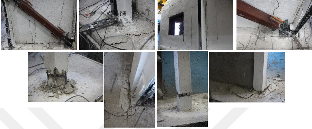
Şekil 4.67 %2 görelî kat ötelemesinde gözlenen hasarlar
