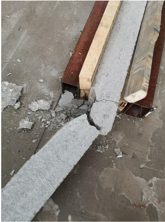
Şekil 4.36. Yatay çekme kuvvet etkisinde mesnet noktasında oluşan kırılma
