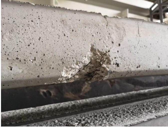
Şekil 4.26. 6 toronlu 12 ton ÖBK'de eğilme deneyi sonucu oluşan kırılma ve çatlaklar
