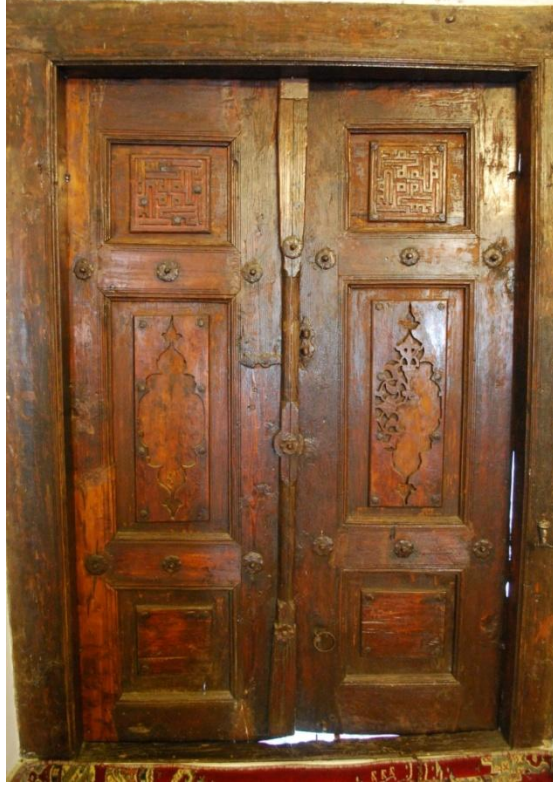
Fotoğraf 11: Süleymaniye Camisi'nin güney duvarın alt kademede ki pencere kanatları
