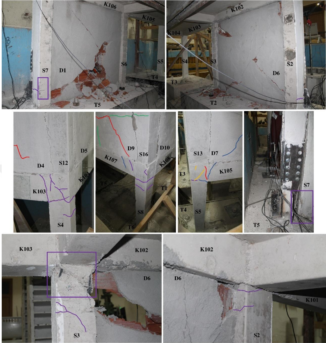
Şekil 4.27. Deney sırasında (%2.0 GKÖÖ'da) GDE-2'ye ait betonarme yapıda gözlenen hasarlar
