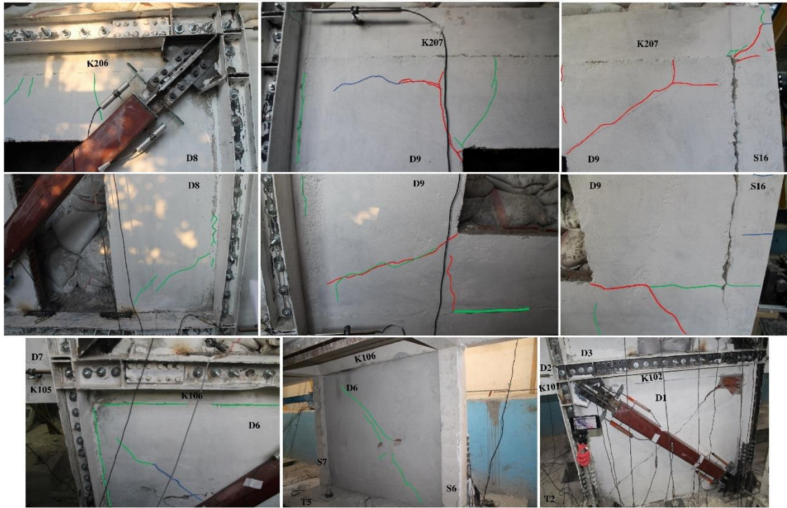
Şekil 4.25. Deney sırasında (%1.0 GKÖÖ'da) GDE-2'de gözlenen hasarlar
