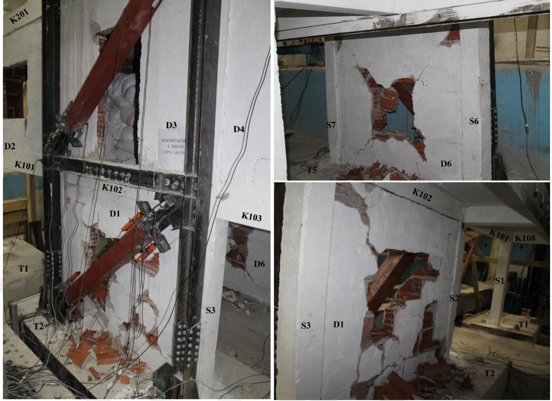
Şekil 4.47. Deney sırasında (%2.0 GKÖÖ’da) GDE-3’te gözlenen hasarlar (2’nci kısım)
