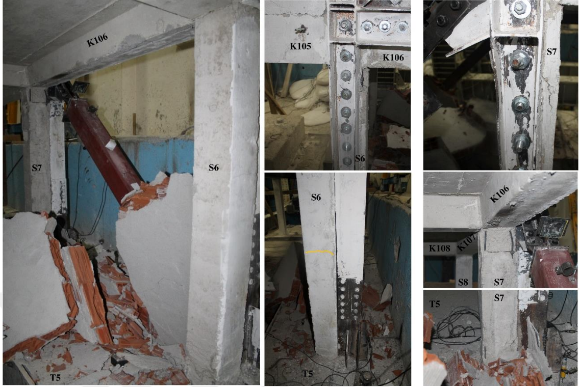
Şekil 4.36. Deney sırasında (%3.5 GKÖÖ'da) GDE-2'ye ait betonarme yapıda gözlenen hasarlar (2'nci kısım)
