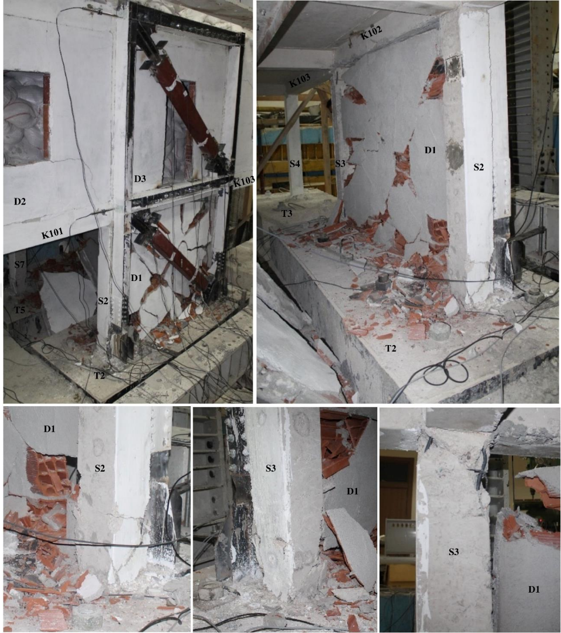
Şekil 4.31. Deney sırasında (%3.0 GKÖÖ'da) GDE-2'ye ait betonarme yapıda gözlenen hasarlar (1'inci kısım)
