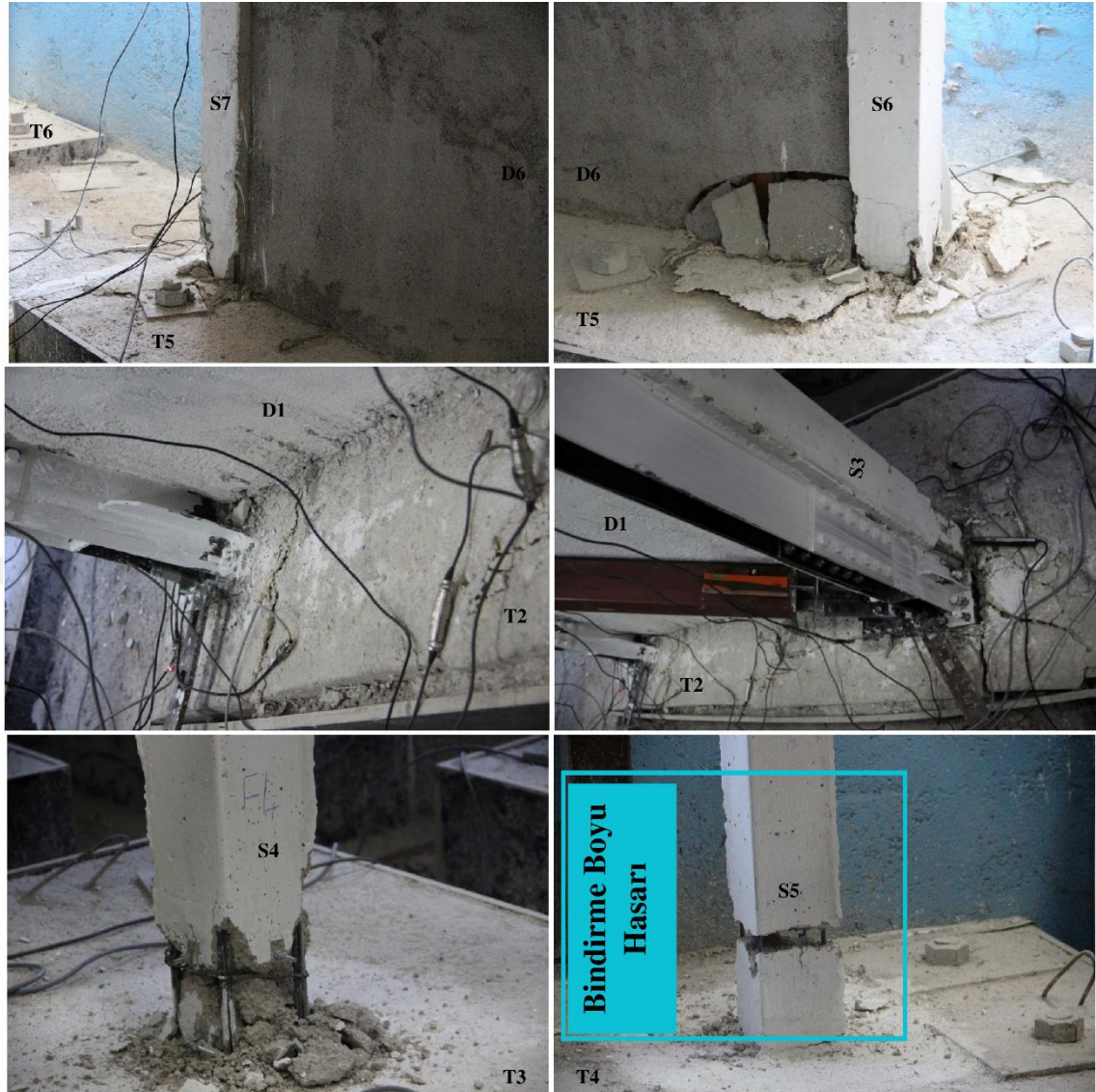
Şekil 4.19. Deney sırasında (%3.0 GKÖÖ’da) GDE-1’de gözlenen hasarlar
