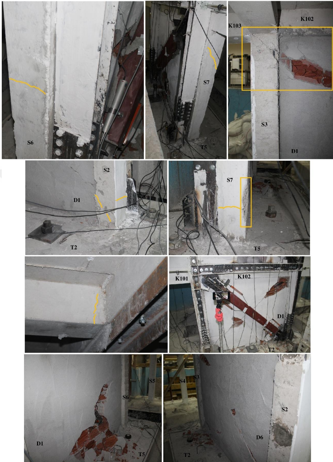
Şekil 4.26. Deney sırasında (%1.5 GKÖÖ'da) GDE-2'de gözlenen hasarlar
