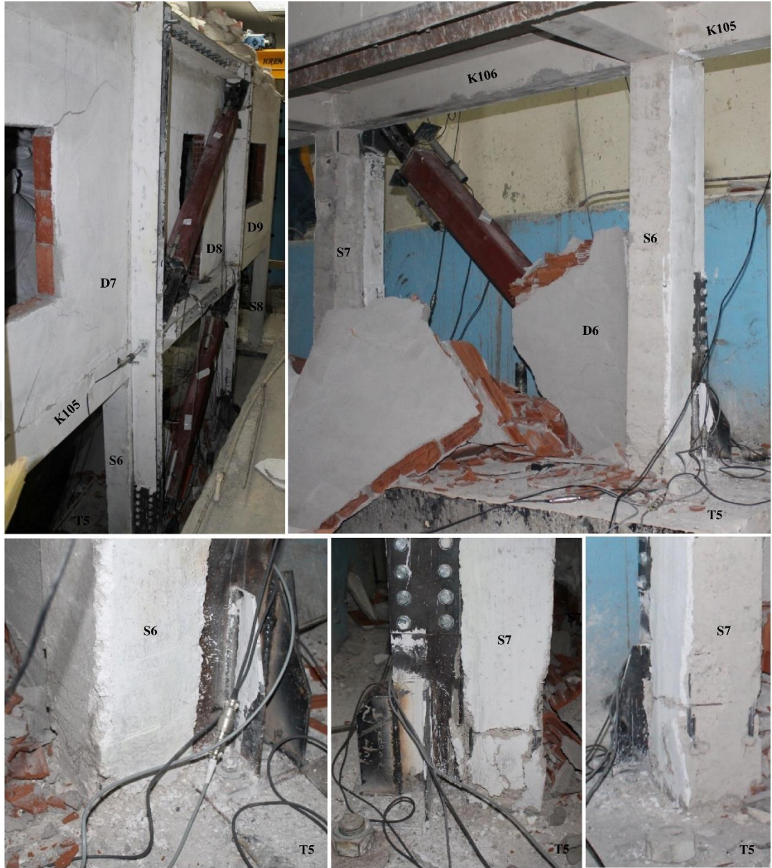
Şekil 4.32. Deney sırasında (%3.0 GKÖÖ'da) GDE-2'ye ait betonarme yapıda gözlenen hasarlar (2'nci kısım)
