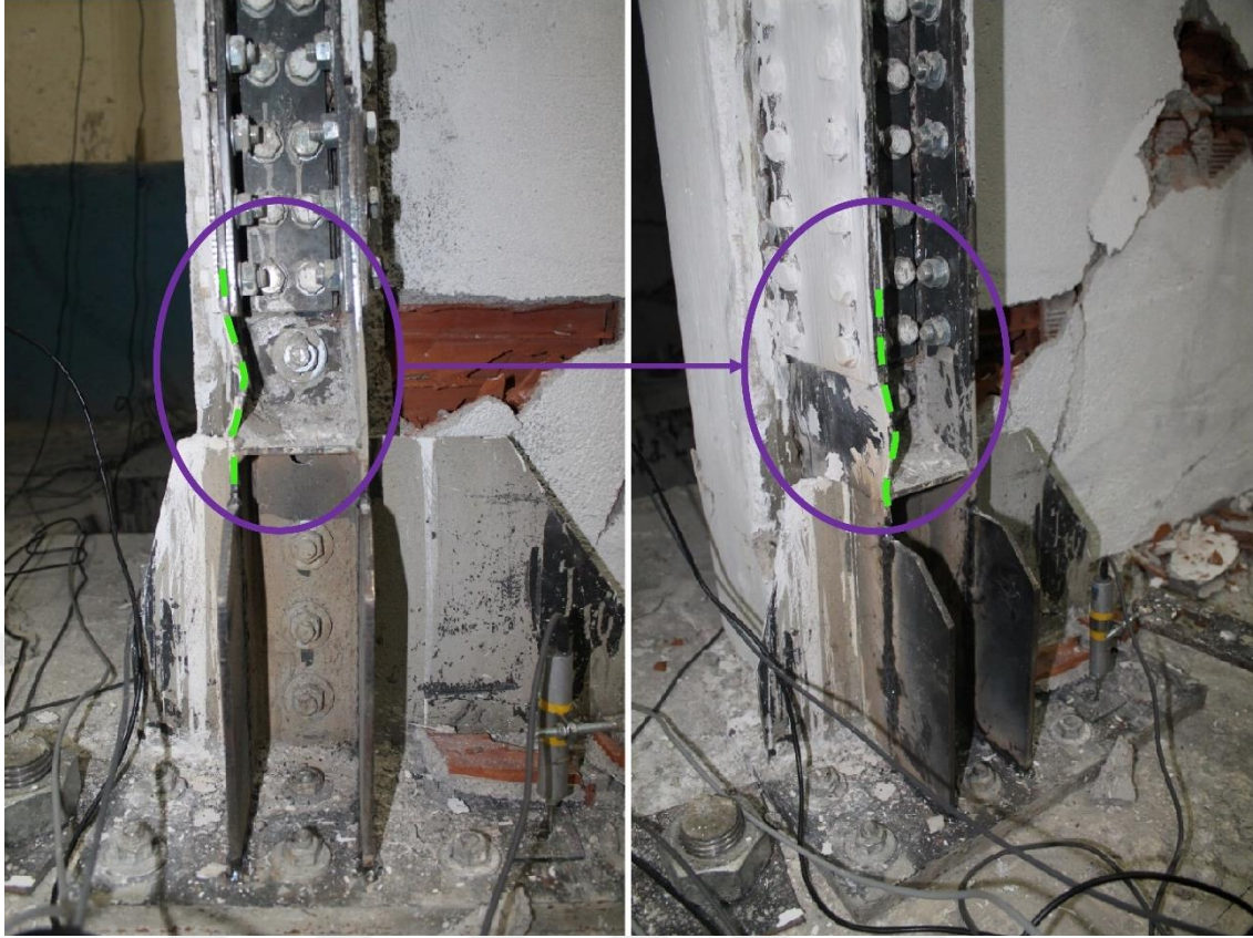
Şekil 4.28. Deney sırasında (%2.0 GKÖÖ'da) GDE-2'ye ait çelik çerçevelerde gözlenen hasarlar
