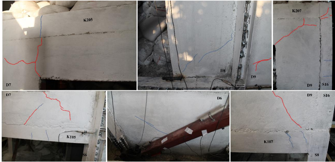
Şekil 4.24. Deney sırasında (%0.5 GKÖÖ'da) GDE-2'de gözlenen hasarlar
