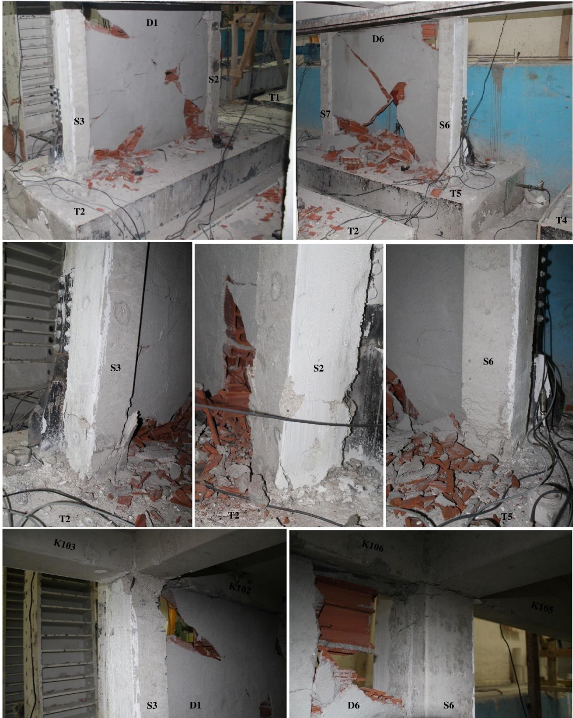
Şekil 4.29. Deney sırasında (%2.5 GKÖÖ'da) GDE-2'ye betonarme yapıda gözlenen hasarlar
