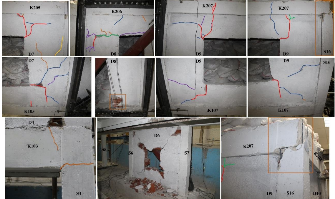
Şekil 4.48. Deney sırasında (%2.5 GKÖÖ’da) GDE-3’e ait betonarme yapıda gözlenen hasarlar
