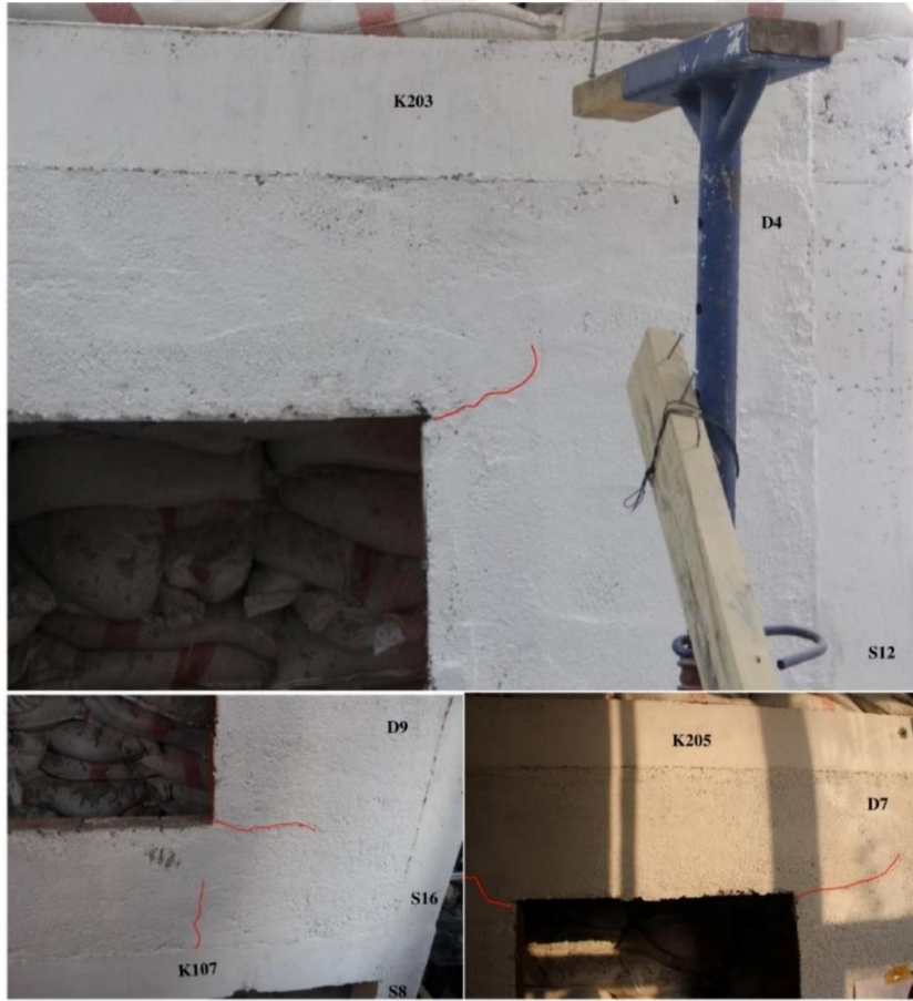
Şekil 4.11. Deney sırasında (%0.3 GKÖÖ’da) GDE-1’de gözlenen hasarlar
