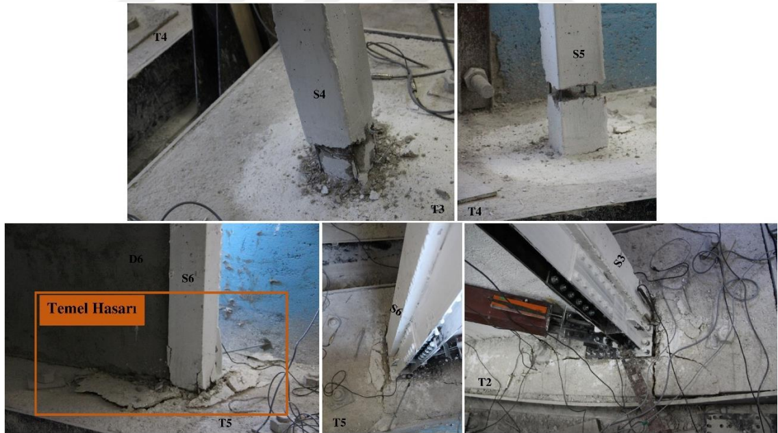
Şekil 4.18. Deney sırasında (%2.5 GKÖÖ'da) GDE-1'de gözlenen hasarlar
